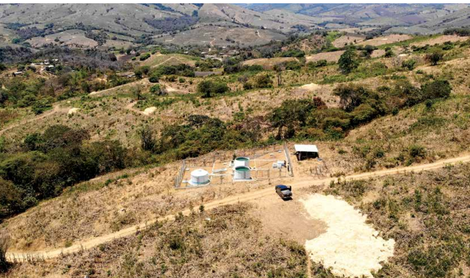
Proyecto piloto de planta de agua potable. Guineo Chico - Loja, Ecuador.
